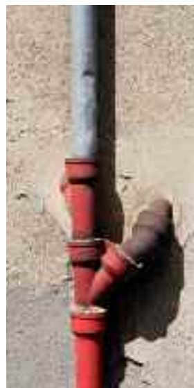
raccordement non conforme
