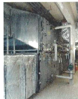
centrale de traitement d'air, pompe à chaleur récupérateur
